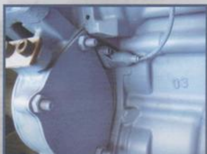
Sensor de fase no motor MWM (ao lado da antiga bomba injetora)
